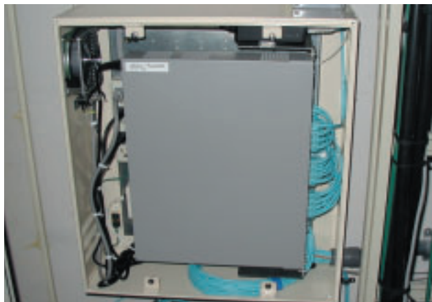
【写真3】 共有部に設置された24ポートスイッチングHUB
