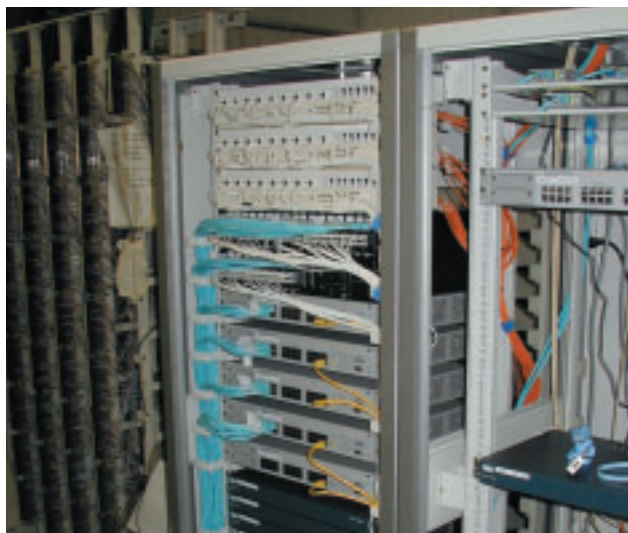
【写真2】 地下1Fの機器室(MDF室)
