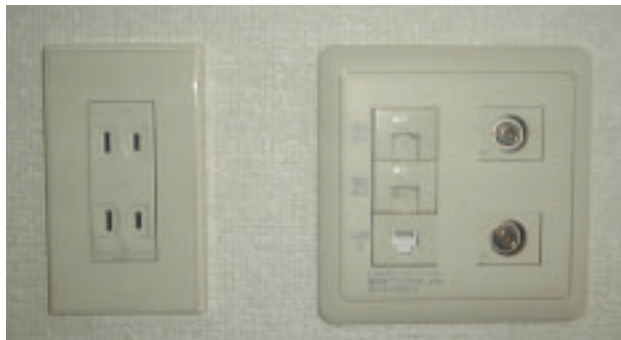
【写真6】 住居内の情報コンセント
