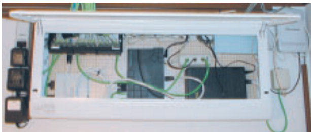
(写真6) 情報配線盤写真
