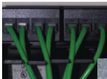
【写真1】 CAT6パッチパネル
